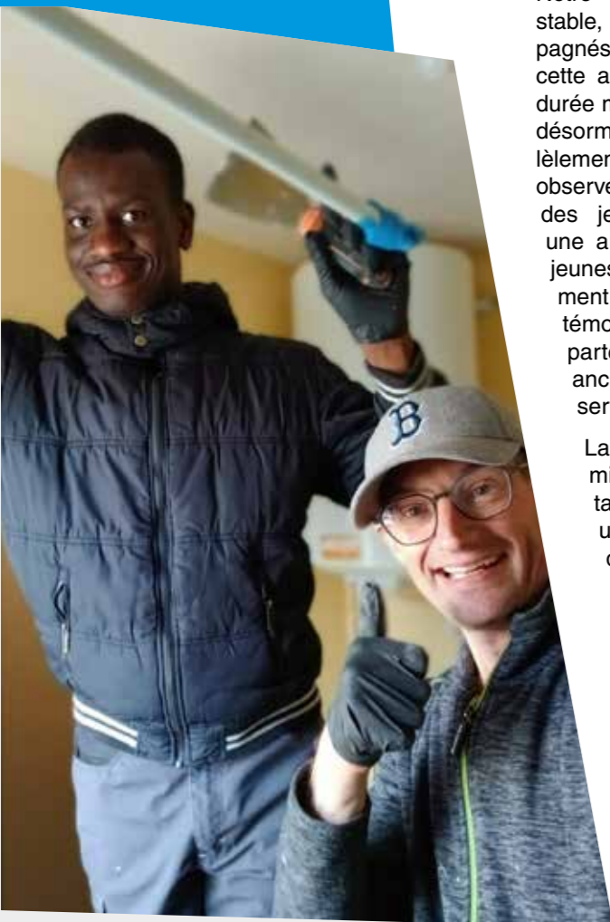
Chris, accompagné depuis ses 14 ans par le service, et Bruno, ouvrier d'entretien, sur un chantier de rénovation
